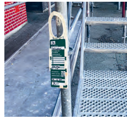
Grønt stillads-skilt: Korrekt afmærket, korrekt udfyldt - løbende opdateret
